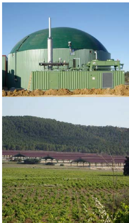
Vista del digestor mezcla completa con el motor en el frente (500kWe) y vista general de las instalaciones de la Granja San Ramón en Campo Arcís (Paterna-Valencia).
